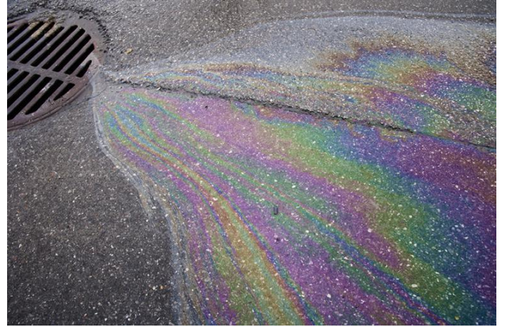
Asfalt Üzerinde Gökkuşağı
